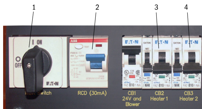
Рис. 66: Главный выключатель и предохранители в блоке управления
